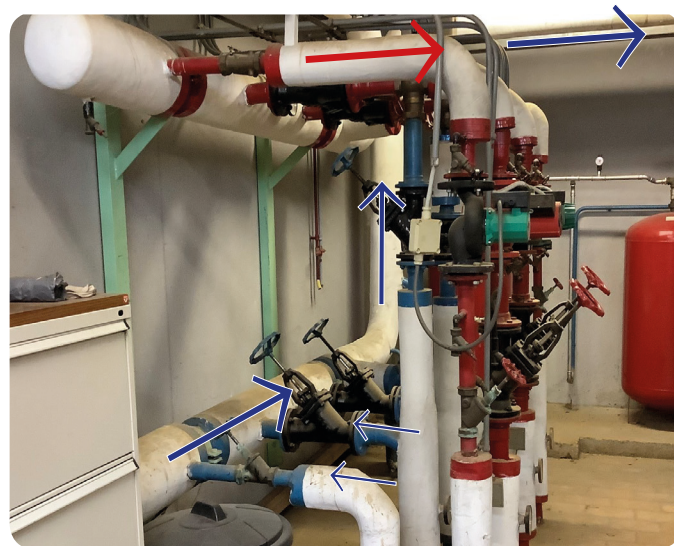
Retour de l'eau froide à la chaudière Départ de l'eau chaude vers les radiateurs des classes
